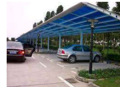
カーポートの紫外線劣化
